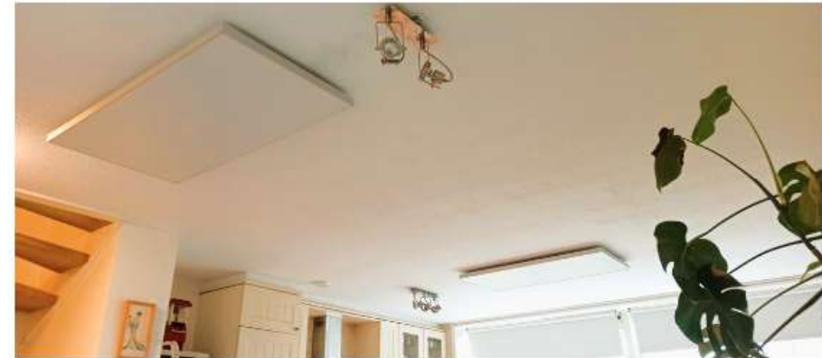
Infraroodpanelen in de woonkamer van Anne
